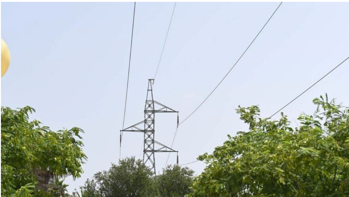
El cableado de una de las torres. / IVÁN URQUÍZAR
